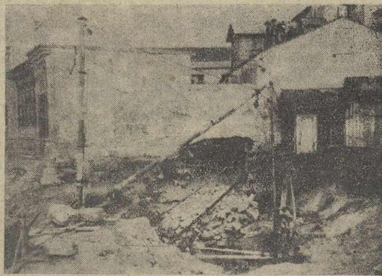
El oleaje ha trabajado de firme estos días los cimientos de las edificaciones de Riazor. En la foto puede apreciarse el boquete abierto en la casa de baños, una de cuyas paredes amenaza derrumbamiento
