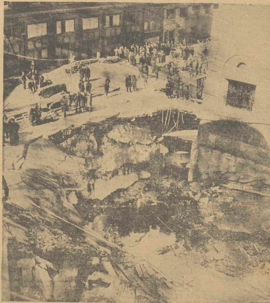
Una vista del aparcamiento de automóviles en construcción en la Plaza de los Mostenses de Madrid, que se hundió a primera hora de la mañana del Jueves Santo.
