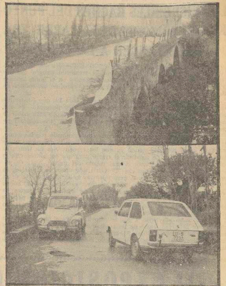
Dos vistas del Puente Viejo, en la carretera de Sarria a Becerreá, que presenta un lamentable aspecto, y que por su estrechez debería de tener una sola dirección. La otra dirección podría ir por la carretera de Villar de Sarria. — (Foto VILLARABID)
