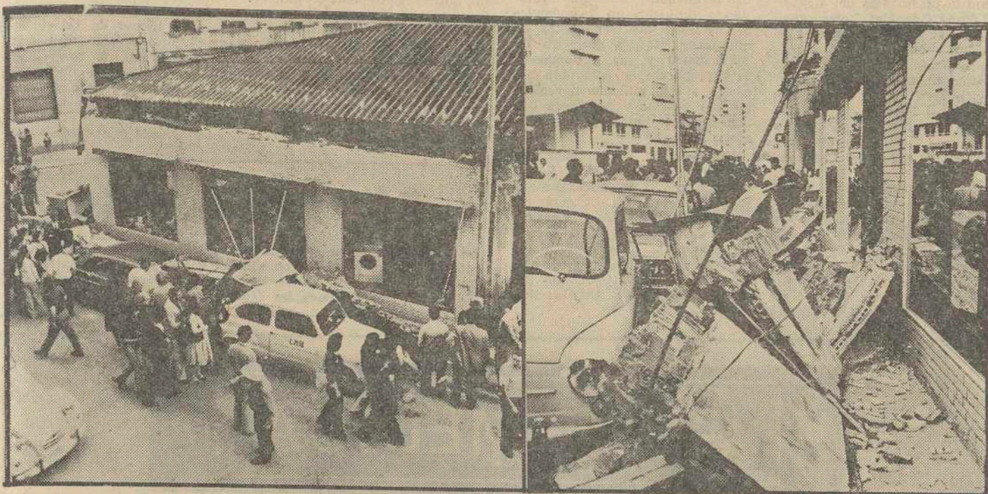
Dos aspectos de la cornisa que se ha desprendido en un inmueble monfortino, de cuyo suceso hemos dado cuenta días pasados y que como nuestros lectores saben no ha producido víctimas, sino tan solo algunos desperfectos en los vehículos aparcados en dicha zona de la ciudad. — (Fotos ARCADIO)
