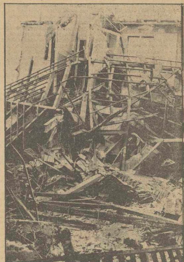
Aspecto parcial de los destrozos registrados en el chalet-vivienda situado en el número 11 de la plaza de Arriba España, en las proximidades del polígono de Santamarca de Madrid, a causa de una explosión de gas que se produjo a las ocho y veinte de la mañana. Tres niños de 8, 7 y 3 años resultaron muertos y dos hermanos de los anteriores recibieron heridas de gravedad, así como sus padres y dos de los abuelos, que resultaron con heridas leves. Al parecer fueron seis las bombonas que estaban almacenadas en el inmueble y que al hacer explosión ocasionaron el siniestro. (CIFRA GRAFICA)
