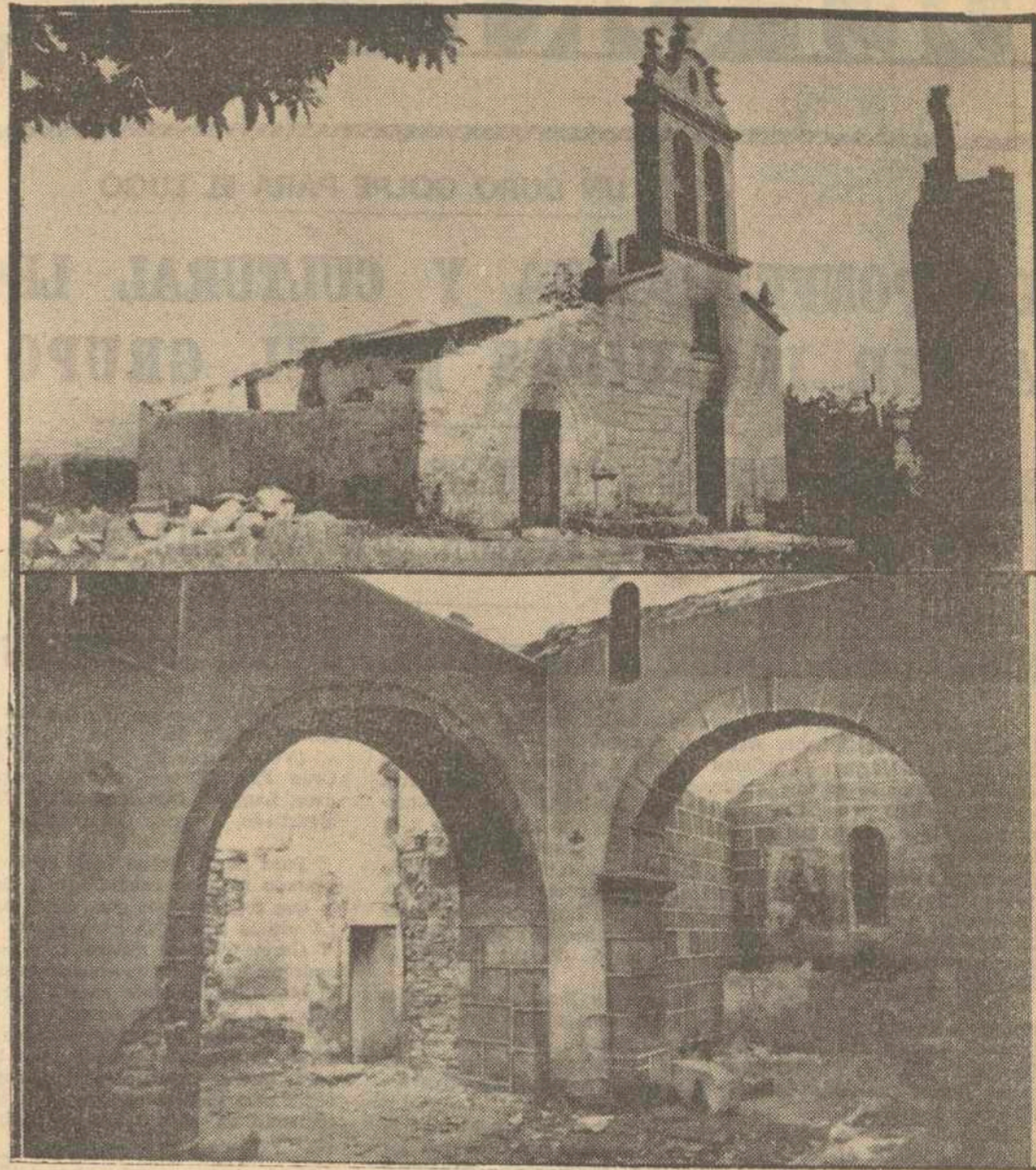
Como ya hemos informado a nuestros lectores, el domingo, día 13 de los corrientes, un voraz y rápido incendio redujo a cenizas la iglesia parroquial de Betote, municipio de Sarria. Unicamente quedaron en pie las paredes descarnadas y, en la espadaña, empuedecidas, las campanas. Retablos e imágenes quedaron reducidos a cenizas. A la iglesia, como fácilmente pueden apreciar nuestros lectores, se le había añadido en mala hora, hace tiempo, un antiestético y absurdo alpendre que la afeaba notablemente y de consistencia mucho menor que la del resto de la fábrica. Ahora, los vecinos de Betote piensan en la tarea de la reedificación de su iglesia, en la que los organismos competentes no pueden dejarlos solos. — (Foto VILLARABID)
