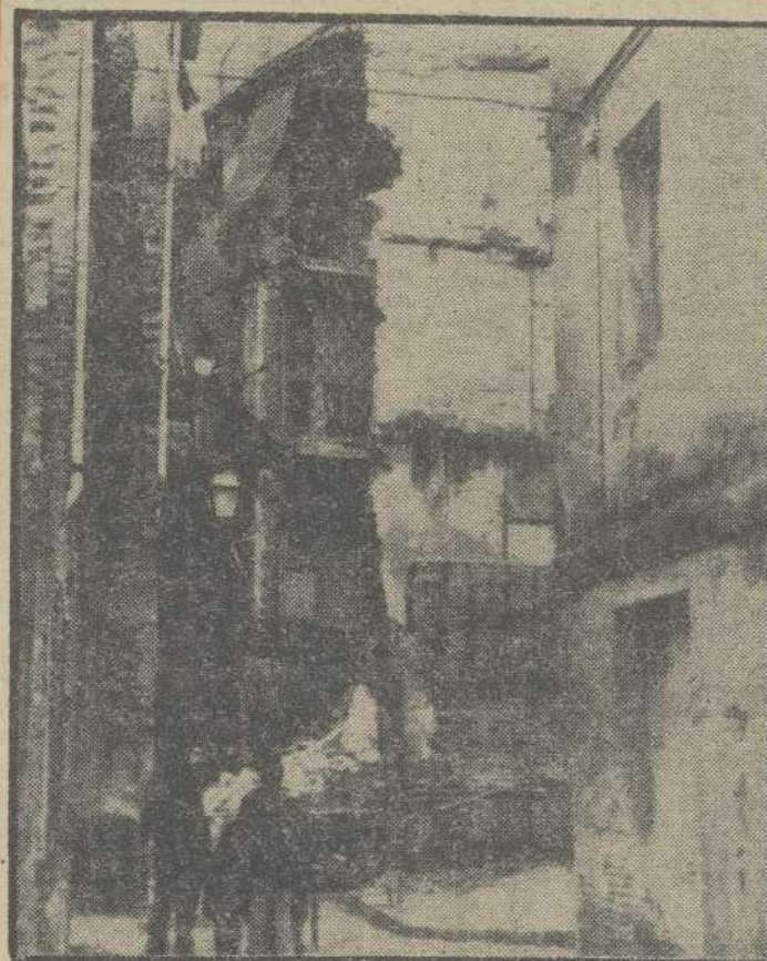
Esta es la finca que, situada en la calle del Mirto de Valencia, hubo de ser desalojada al venirse abajo, quedando cortada por las habitaciones como bien puede verse en la fotografía. - (Foto Cifra Gráfica)
