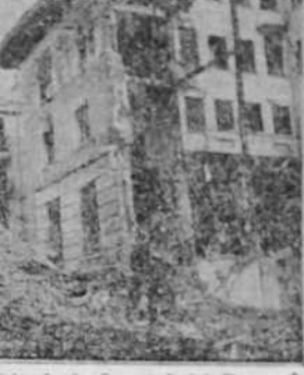
Estado en que ha quedado el edificio de la Curacal del Banco de España, en Teruel, después de la breve dominación de las hordas del Campesino.
