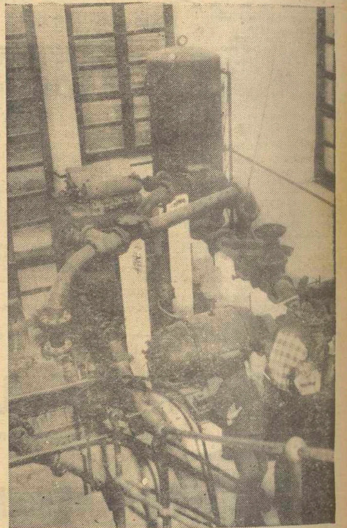
Sala de máquinas de la antigua Estación Elevadora de agua del Tambre.
