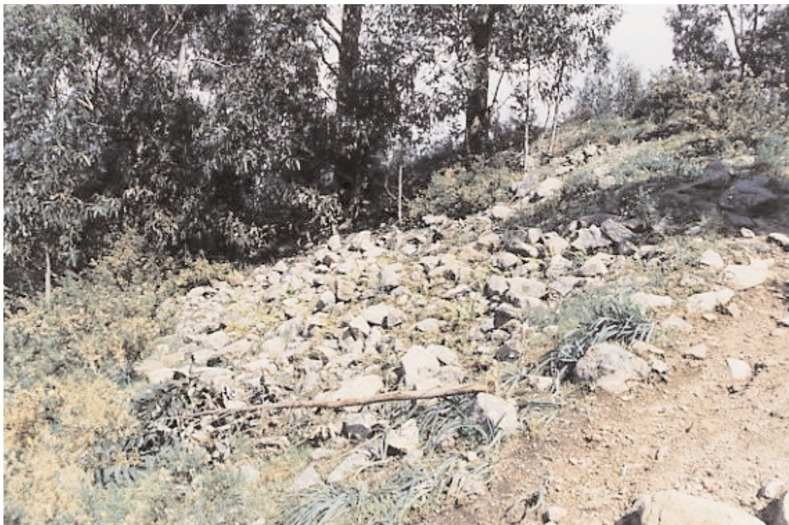
DERRUBE DA MURALLA NO SECTOR OESTE
