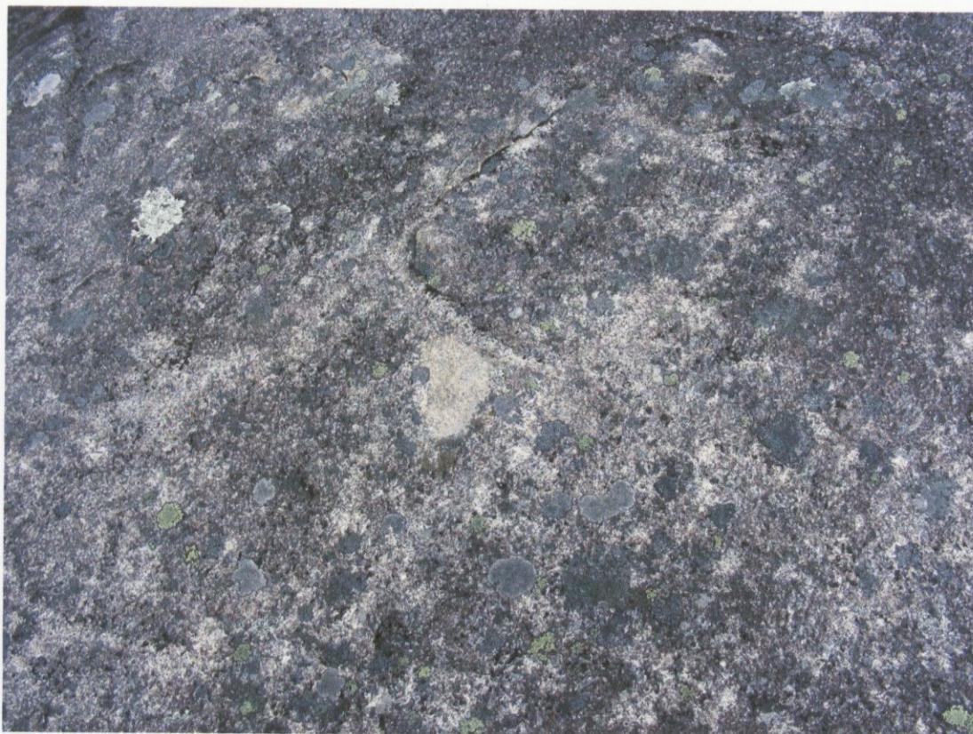
Reactivación de las termoclasas, tras el incendio de 2006
